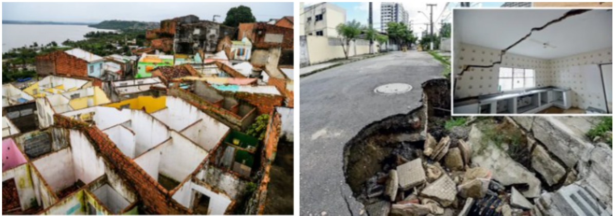
Figura 3 – Bairro Pinheiro em estado de abandono em 2020 à direita e imagem do afundamento e fissuras em Maceió à esquerda
